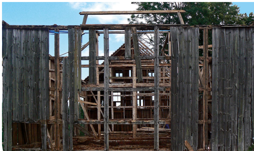
Stan zachowania stodoły w konstrukcji ryglowej przed podjęciem prac
