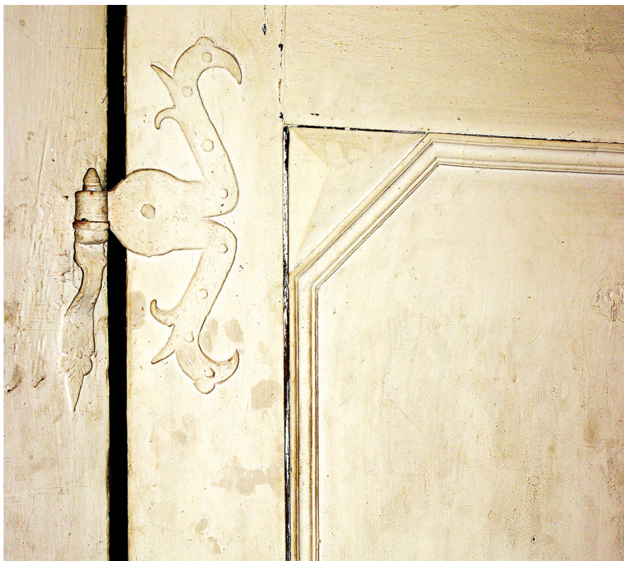
Barokowe drzwi w jednym z domów żuławskich. Szczególnie ważne jest zachowanie oryginalnych okuć stolarki
