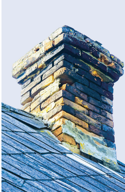
Komin powyżej dachu, uszkodzenia cegieł komina
