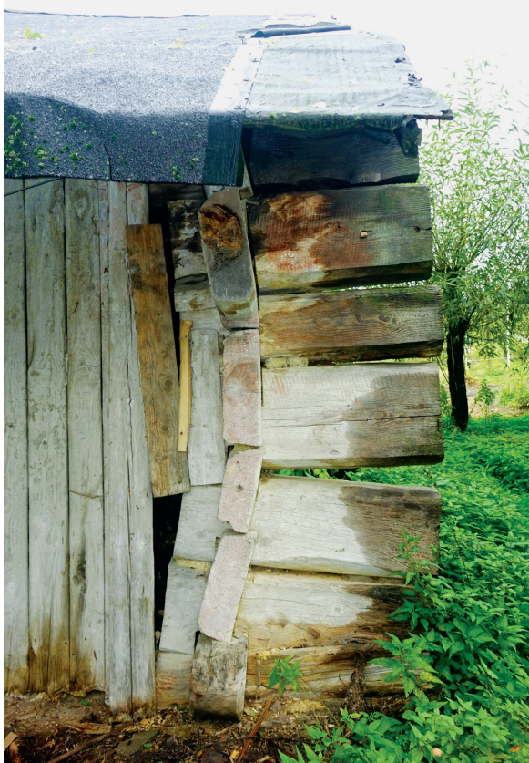
Ściany konstrukcyjne budynku wieńcowego (chyży) z widocznym wybozieniem
