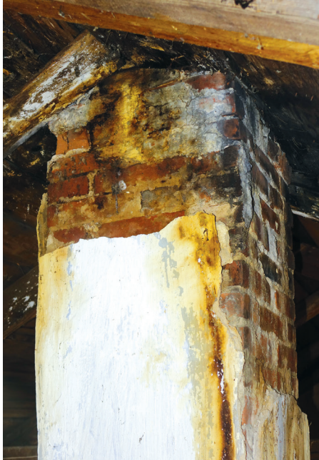
Komin na odcinku poddasza, widoczne uszkodzenia tynku i wątku cegieł
