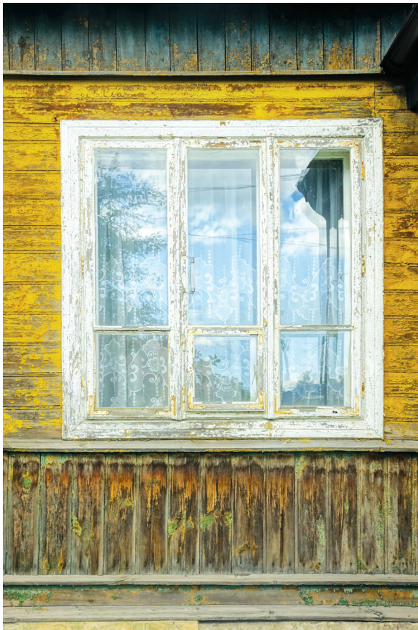
Stolarka okienna z widocznymi ubytkami oszklenia i powłoki malarskiej
