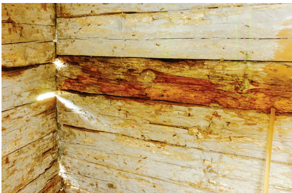
Ściany konstrukcyjne budynku z uszkodzeniami od wewnątrz
