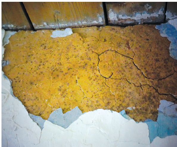
Tynk gliniany pokryty wapnem z widoczną pleśnią na części odsłoniętej
